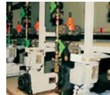
Перекачивание хлорида железа на очистной станции.
