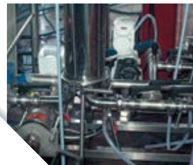
Насос в составе фильтрационного оборудования (производство вина).
