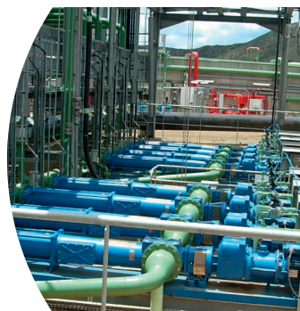
Pompes floculants avec multiples points d'injection. Mine d'or, usine de préparation de floculants.
