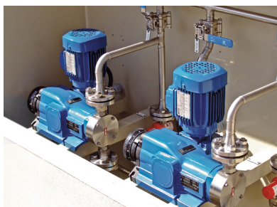
Schwefelsäuredosierung im Bergbau
