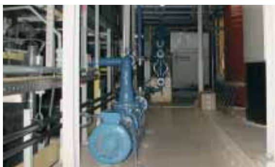
Alimentación de filtro prensa dentro de un taller de tratamiento de superficie
